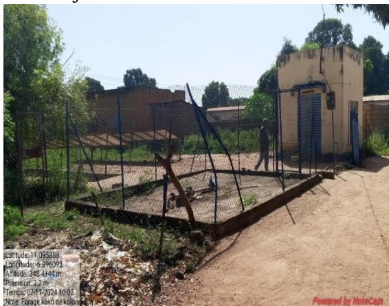
Photo 6: Site du forage Fonctionnel
