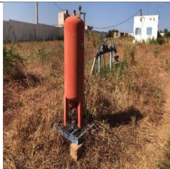
Photo 2: Poste de distribution d'eau à Koulikoro
