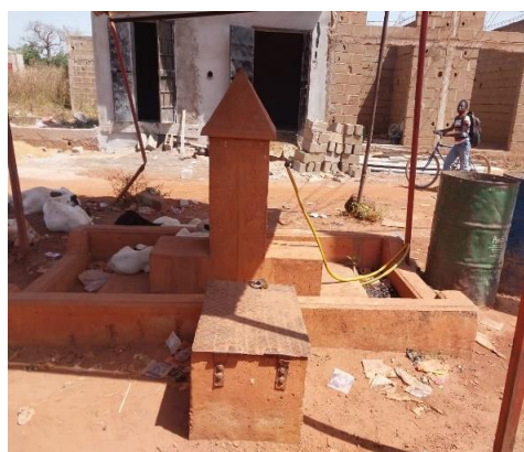
Photo 4 : Une borne fontaine le long du tracé de la conduite
